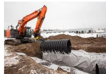
Kustannustehokas ja luotettava ratkaisu hulevesien hallintaan Volvon varastorakennus, Vantaa
